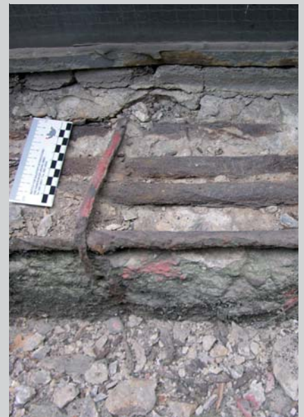
6: Extremfall der Stahlkorrosion in carbonatisiertem Beton
