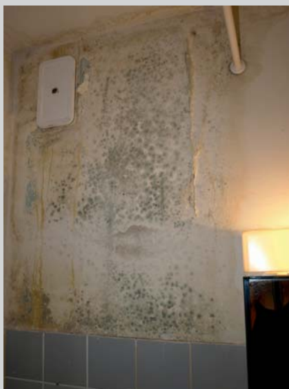
7: Flächige Schimmelbeläge in einem Bad. Hier besteht erhebliche Gesundheitsgefährdung
