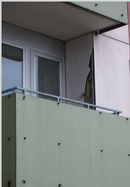
4: Fassaden- und Balkonverkleidung. Hier sind bereits Teile der Platten abgerissen, was zum Freisetzen von Fasern führen.
