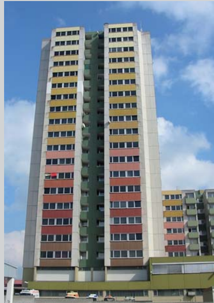
2: Überblick über die Westseite. Im oberen Drittel sind ausgetauschte Fassadenplatten erkennbar
