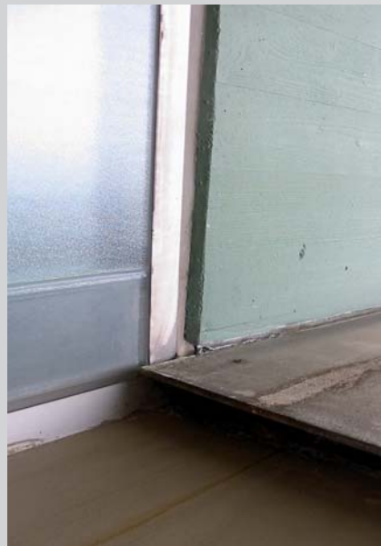
5: Eines der zahlreichen Details, das im Hinblick auf das neue Wärmedämmverbundsystem präzise geplant werden muss.
