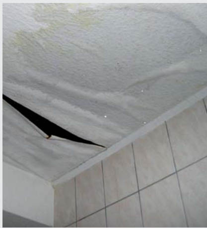
Abb. 2: 15 cm starke Stahlbetondecke unter dem nicht beheizten Dachstuhl. Die Wärmedämmung ist lose ausgelegt und höchst lückenhaft. Kondensat tropft von der Decke herab.
