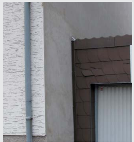
Abb. 3: Häufig unterschätzt: Spritzwasserbereich oberhalb eines Garagenanschlusses an ein Wohnhaus. Der alte Putz wird durchnässt, es kommt zur Ausbildung einer Wärmebrücke durch die reduzierte Wärmedämmung der nassen Außenwand.
