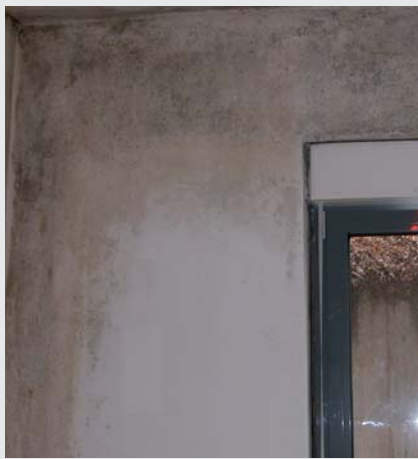
Abb. 1: Wärmebrücke in einer Außenwand, die zum Teil von einem ungedämmten Stahlbetonbauteil gebildet wird.
