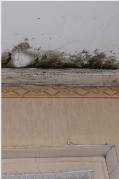
Schräg gestellte Fenster verursachen häufig starkes Schimmelpilzwachstum im direkten Umkreis.
