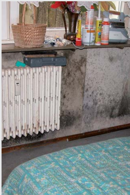
Durch „Null-Lüftung“ entstandene extreme Schimmelpilzbelastung in einem Schlafzimmer.
