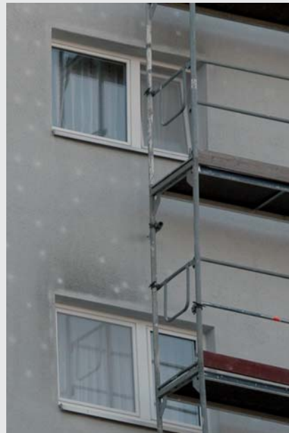
Verstärktes Algenwachstum und Schmutzanlagerung außen am Fenstersturz – bedingt durch dauernd gekippte Fenster.
