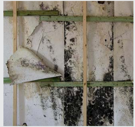
Abb. 3: Auf einfache Holzlattung aufgebrachte Gipskartonplatten mit 25 mm Polystyrolschicht: Dahinter kam es zu starker Durchfeuchtung und extremem Wachstum von Schwarzsimmel.
