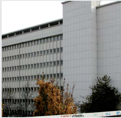
Abb. 2: Bei dem Bürogebäude mit starker Aufgliederung in einzelne Fensterachsen ist eine Außendämmung kaum möglich.
