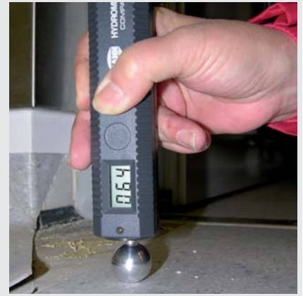
Abb. 3: Kapazitive Feuchtemessung mit Kugelkopfsonde an einem Fußboden nach Wasserschaden.
