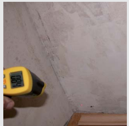
Abb. 3: Oberflächentemperatur der Außenwand beträgt nur 8 °C. Kondensatschäden vorprogrammiert
