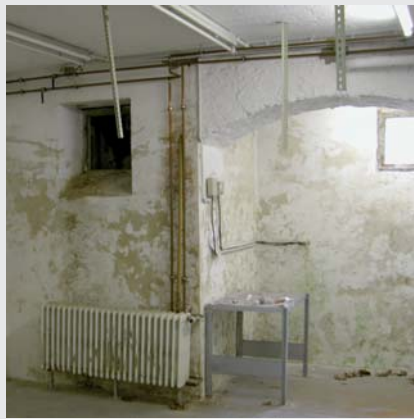
Abb. 2: Flächig über die Außenwand eindringende Feuchtigkeit infolge fehlender Vertikalisolierung
