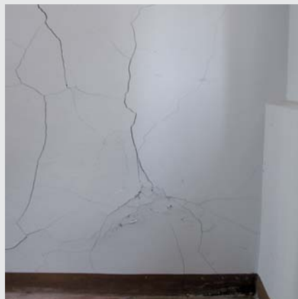
Abb. 1: Risse und Putzablösungen infolge großer Mengen bauschädlicher Salze, die nach einer Isolierung nach außen dringen.
