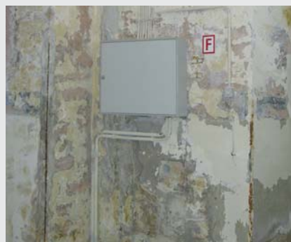
Abb. 5: Flächige Putzablösungen durch Feuchtigkeit im Mauerwerk
