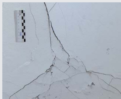
Abb. 4: Ablösungen und Risse aufgrund starker Versalzung und Durchfeuchtung
