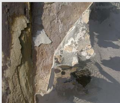
Abb. 2: Putzablösung flächig, einschließlich des eingelegten Gewebes, wegen starker Durchfeuchtung und abdichtendem Anstrich auf der Oberfläche
