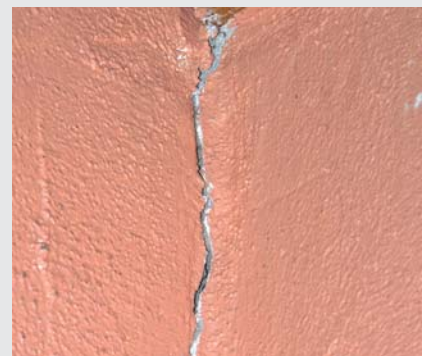
Abb. 3: Riss in einer einspringenden Ecke ohne Fugenausbildung
