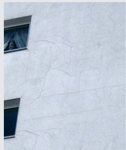
Abb. 6: Teils horizontale, teils ungerichtete Risse, die die gesamte Fläche überziehen.
