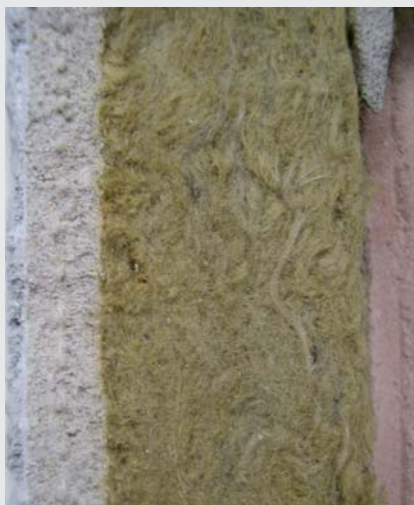
Abb. 4: Richtig eingebautes Gewebe, das hier mittig sitzt und gut in den Armierungsmörtel eingebettet ist.
