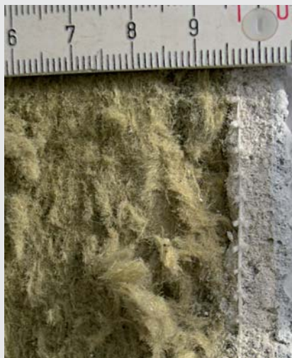
Abb. 5: Falsch eingebautes Gewebe, direkt über der Mineralfaserdämmplatte liegend. Hier kann es die auftretenden Schubspannungen nicht aufnehmen.
