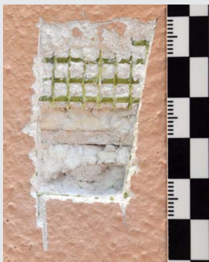
Abb. 2: Beim Öffnen des Risses zeigt sich die Fuge zwischen den Platten gefüllt mit Armierungsmörtel. Dies stellt eine Wärmebrücke und gleichzeitig eine Ursache für Risse dar.
