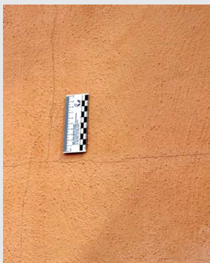
Abb. 1: Senkrechte und horizontale Risse über Fugen der Dämmplatten.
