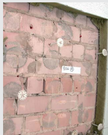
Abb. 3: Nur mit einzelnen Mörtelbatzen war hier die Dämmplatte befestigt, die Ränder waren nicht durch eine Wulst fixiert. Als Folge kam es zu Rissen über den Stoßfugen.
