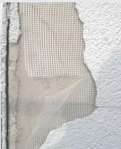
Abb. 7: Flächige Ablösung in der Ebene des Armierungsgewebes an einer Gebäudekante. Hier besteht bereits Absturzgefahr von ganzen Putzplatten.
