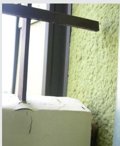
Abb. 5: In eine nur 7 cm starke Stahlbetonbrüstung ist der Geländerpfosten eingelassen. Wegen seiner starken Korrosion wurde das Geländer in „Heimwerkerqualität“ durch angeschweißte Flacheisen verstärkt.
