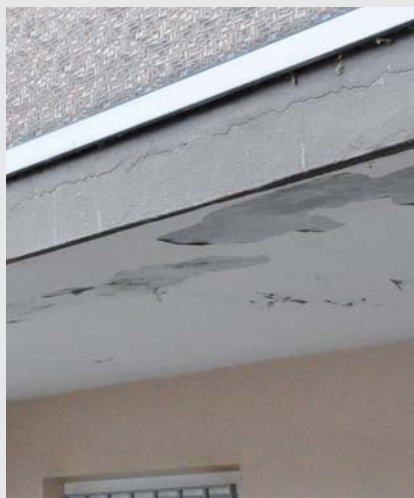
Abb. 2: Ablösungen des Anstrichs an der Unterseite und starke Rissbildung durch rostende Bewehrung an der Stirnseite eines Balkons.
