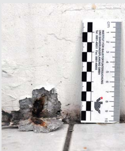
Abb. 4: Schadensursachen und ihre Folgen in einem Foto: Keine Randabdichtung des Fliesenbelags und unzulängliche Entwässerung eines Balkons nur durch ein 20 mm-Röhrchen. Ablösung des Anstrichs und verstärkte Bewehrungskorrosion direkt über dem Belag.
