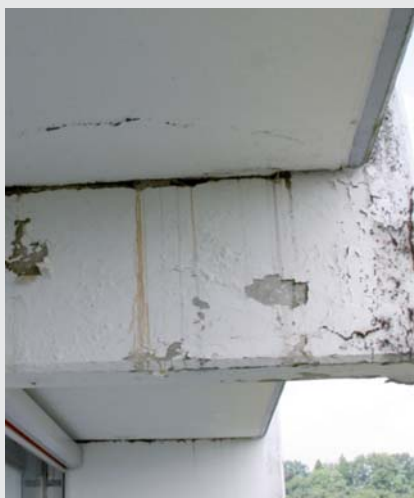
Abb. 1: Stahlbetonbalkonplatte, aufliegend auf einer Betonkonsole. Durch Undichtigkeiten kommt es zu Zerstörungen des Farbansichts an der Konsole. Die Folge der Carbonatisierung ist an der Vorderkante zu sehen: Starke Abrisse wegen rostender Bewehrung.
