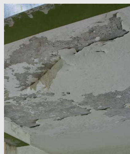
Abb. 6: Untersicht eines Balkons mit völlig desolater Entwässerung und fehlender Abdichtung: Anstrich, Spachtelungen und Betonoberfläche sind geschädigt.
