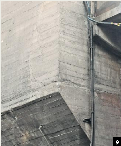
Abb. 9: Sowohl die vertikale Kante dieser Bunkerwand als auch der rechte Teil der schrägen Untersicht waren großflächig geschädigt. Sie wurden originalgetreu wiederhergestellt und dabei die Breite der Brettschalung beibehalten, um das gewünschte Gesamtbild zu erhalten.
