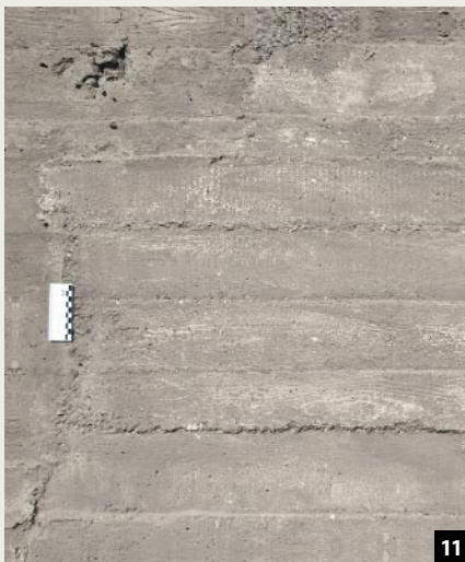
Abb. 11: Ausschnitt aus Abb. 9: Gerade die minimalen Ausbrüche entlang der Schalbretter, die beim Abnehmen der Schalung entstanden, führen zu einem authentischen Erscheinungsbild.
