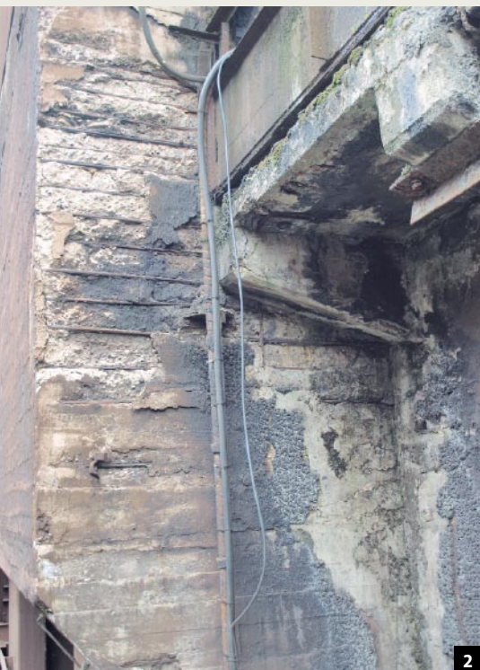
Abb. 2: Die Gebäudeecke im Bereich von Achse 01/02 war stark geschädigt. Ganz links ist die Brettgeschalte Oberfläche zu erkennen. Abbildung 9 zeigt diese Ecke nach der Fertigstellung.
