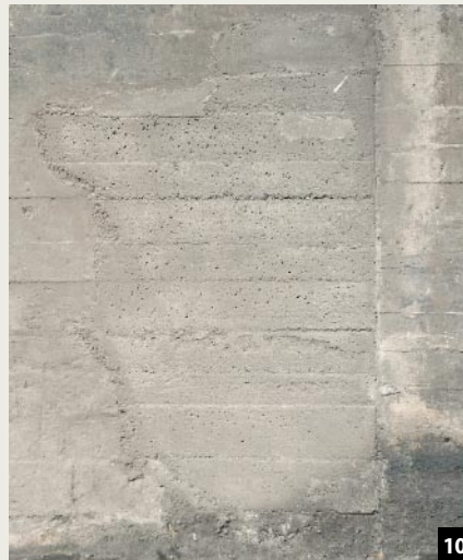
Abb. 10: Detail einer neu reprofilierten Wandfläche: Die Schalungsgrate, kleinere Lunker sowie Poren an der Oberfläche entsprechen nahezu vollständig der angrenzenden Originaloberfläche.
