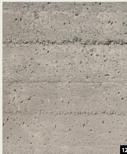
Abb. 12: Sowohl mit der Oberflächenstruktur als auch mit dem Grad der Pigmentierung in der Lasur konnte das Erscheinungsbild der restaurierten Flächen an die lokalen Gegebenheiten des Originals angeglichen werden.
